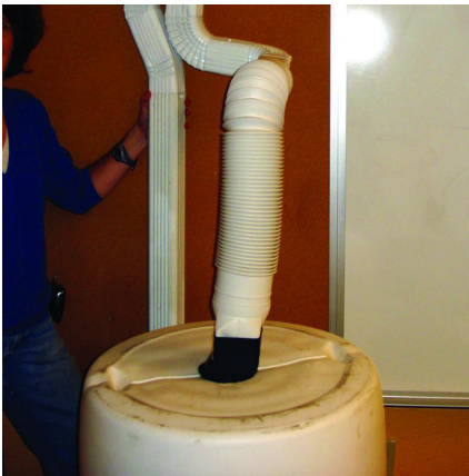
Conexión del bajante de aguas pluviales con el extensor flexible
